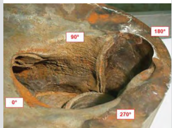
Figura 4. Cavidad en la tapa de la vasija de la central de Davis Besse
